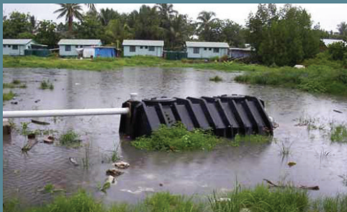
Gambar 1.3 Pengolahan air limbah keluar dari permukaan air
