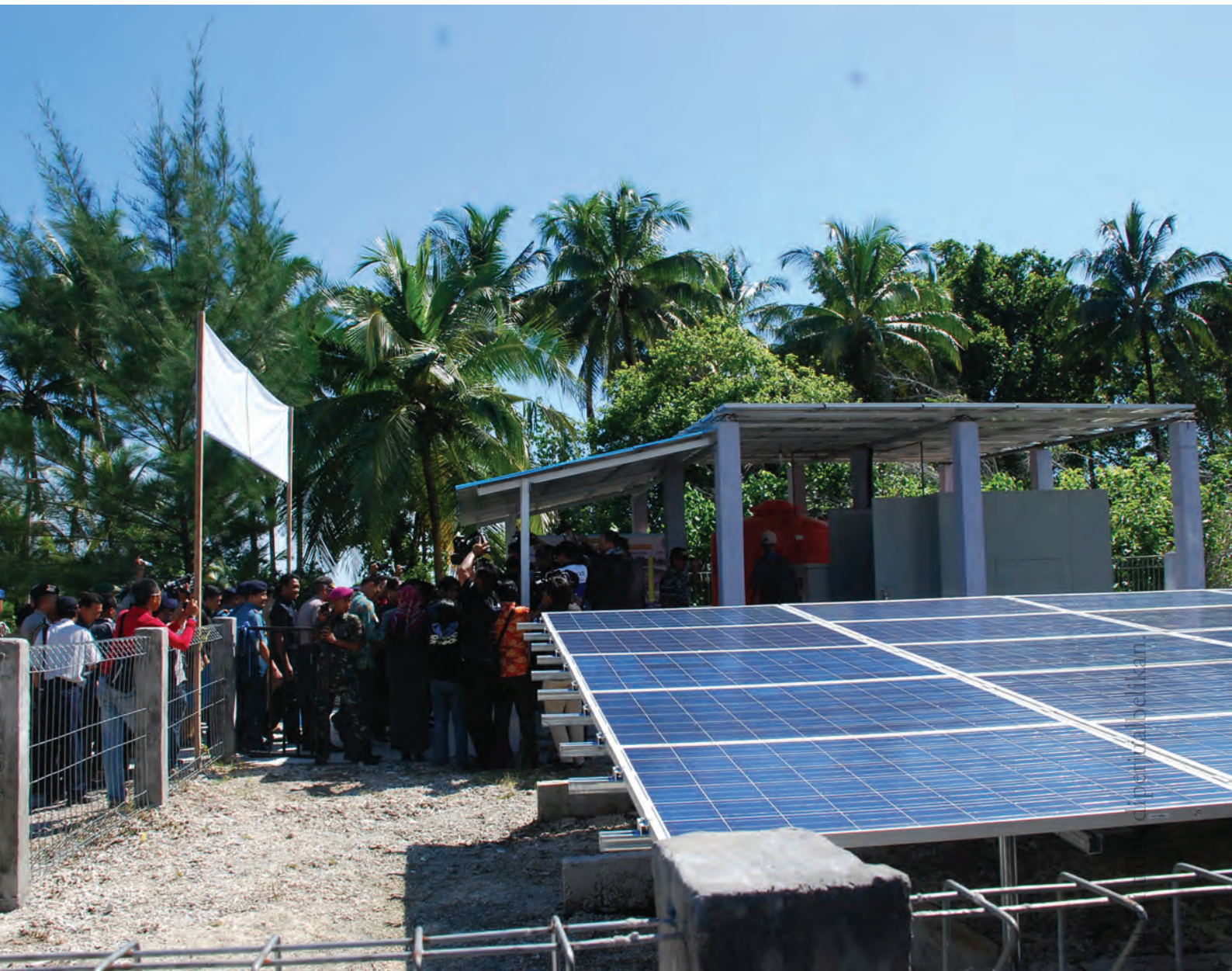
Stasiun Pembuat Air Tawar (Desalinasi) dan Stasiun Pembangkit Listrik Tenaga Surya di Pulau Enggano yang diresmikan Gubernur Bengkulu pada 24 Maret 2015.
