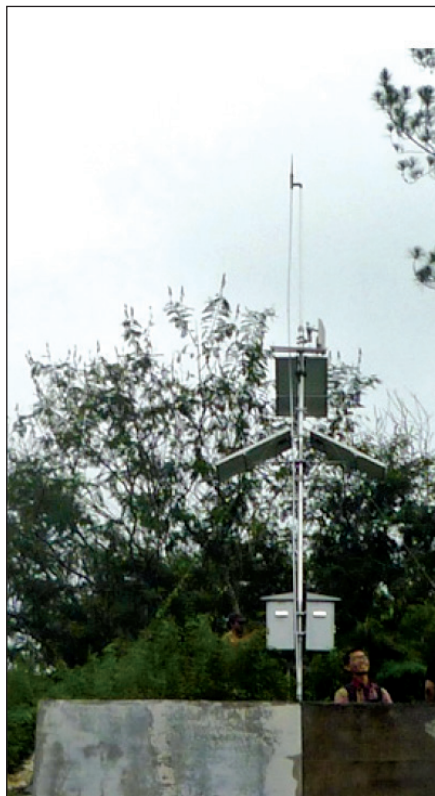
Gambar 9. Foto stasiun seismograf deteksi lahar awal di sabo dam PU-C13.
