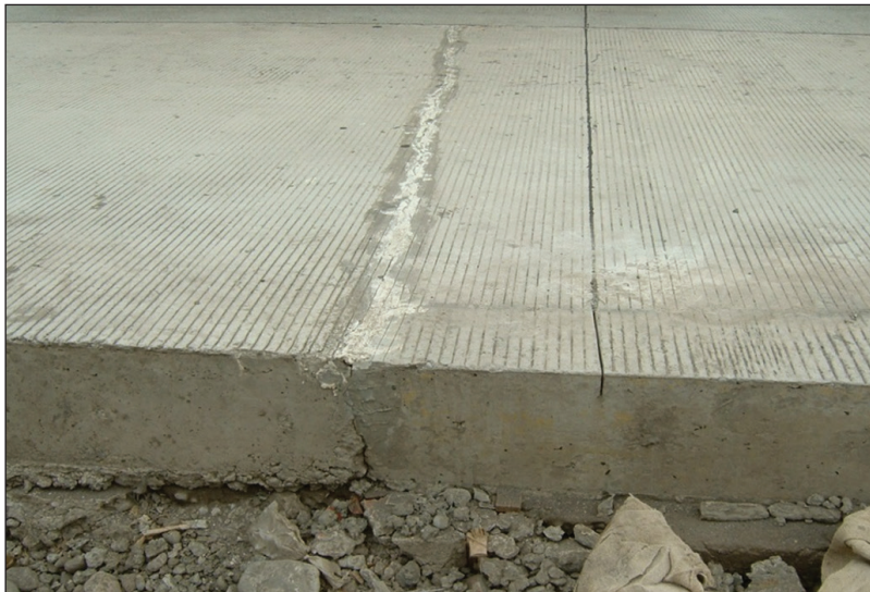
Gambar 66. Retak Terjadi Akibat Terlambat/Kurang Dalam Penggergajian
