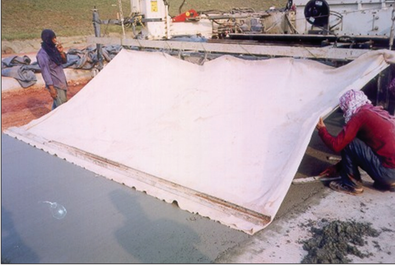
Gambar 46. Penghalusan Beton dengan Pelepa dan Pembuatan Alur Awal dengan Penarikan Kain/Karung Goni
