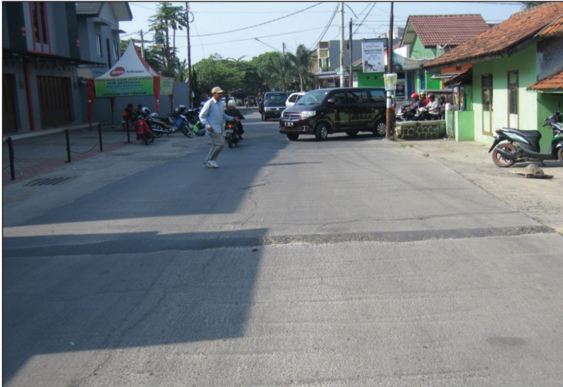
Gambar 55. Retak Memanjang Akibat Tidak Adanya Sambungan Memanjang
