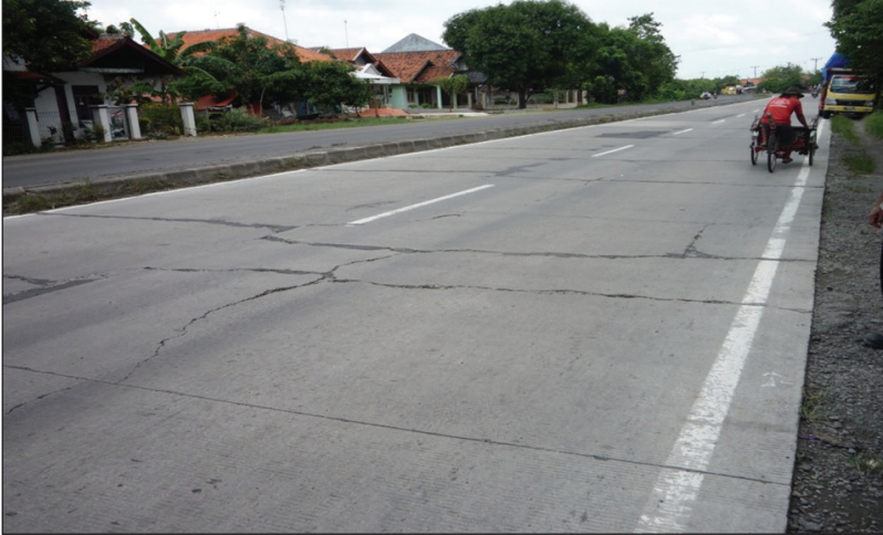
Gambar 52. Tipikal Kerusakan Jalan Beton
