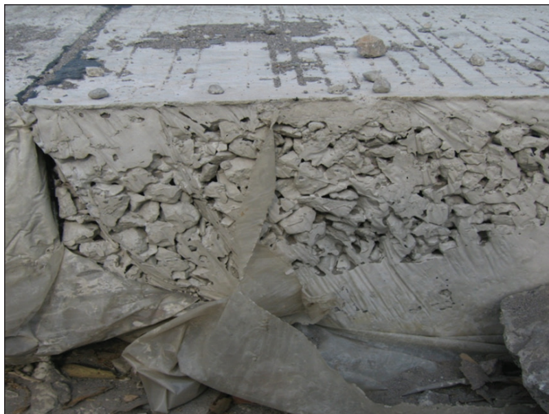
Gambar 63. Pemadatan yang Kurang Baik Menyebabkan Beton Keropos
