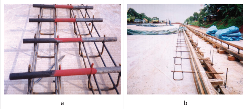
Ket.: a. Ruji ( Dowel ): baja tulangan polos, satu sisi dapat bergerak bebas/tidak diikat b. Batang Pengikat ( Tie bar ); Baja Tulangan Ulir
