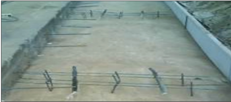
Gambar 53. Tipikal Pemasangan Ruji yang Salah
