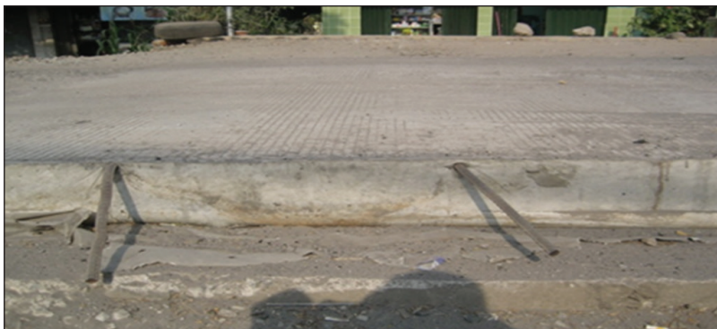
Gambar 54. Tipikal Pemasangan Batang Pengikat yang Salah
