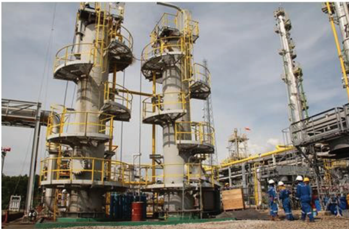
Gambar 10. Unit Desulfurisasi Gas di Medco Lematang yang Menggunakan 15 Ton PIMIT-B1
